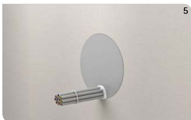
Abschottungen auf Richtigkeit prüfen (Zulassung beachten!).
