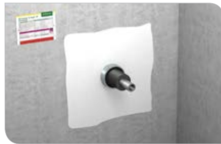
Nicht brennb. Rohr mit brennb. Dämmung.
