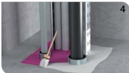
4 Tangit FP 800 Brandschutz-Anstrich oberhalb des Deckenschotts auf den Schaum und 3 cm des angrenzenden Bereichs, bzw. 15 cm auf die Kabel(-trasse) auftragen.
