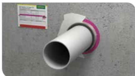
Verschluss von Rest- bzw. Ringspalten oder Durchbrüchen mit Tangit FP 550 2K-Brandschutz- Schaum. Voraussetzung: Ringspalt nimmt min. 40% des Volumens der Kernbohrung ein.
